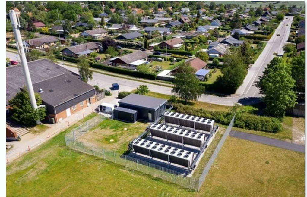
1 MW Luftwärmepumpe (Urheber: PlanEnergi)
